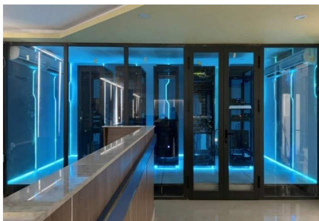
Hình 2. 5. Phòng máy chủ Server (Data Center)
