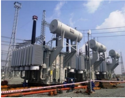
Hình 7. Trạm biến áp 110kV
