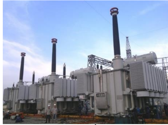
Hình 8. Trạm biến áp 220kV
