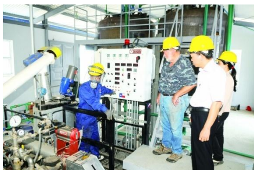
Hình 2.6: Dây chuyền sản xuất tại kho nhựa đường Thọ Quang
