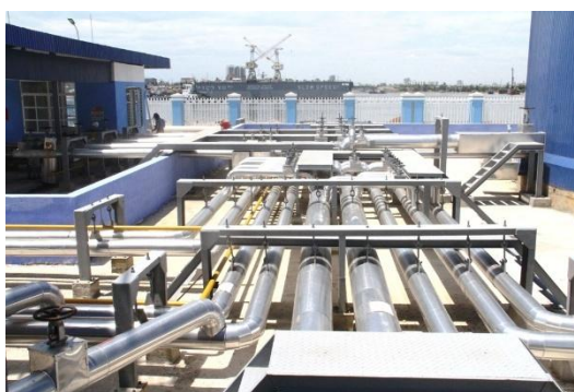
Hình 2.5: Hệ thống đường ống tại kho nhựa đường Thọ Quang
