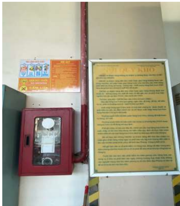
Hình2.10: Hộp cuộn vòi chữa cháy PCCC và Nội quy kho niêm yết tại lối vào
